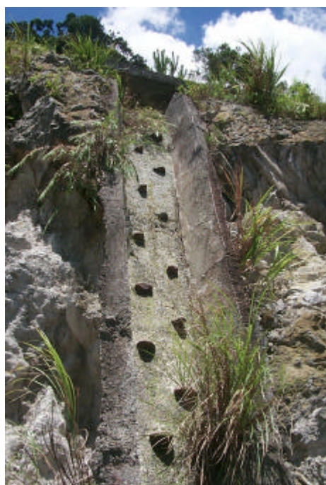
圖(十三)沉砂池北側的裸露山坡上，有人工排水溝，水溝中特別嵌入了大塊鵝卵石。
