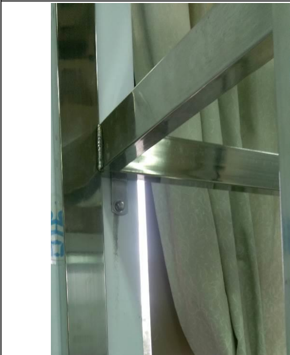
說明：大型系統缸不鏽鋼架鑽牆固定，防止地震發生倒塌
